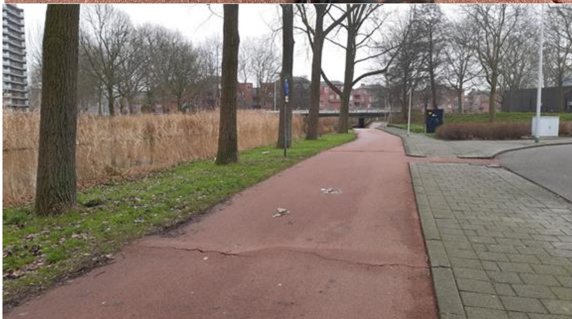
Het Atolpad vertoont diverse scheuren en hobbels in het wegdek
